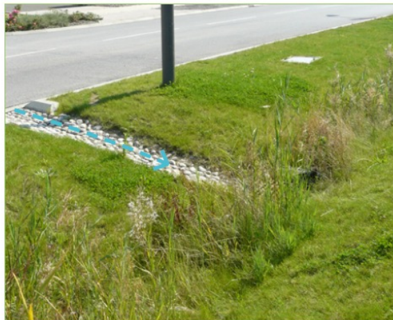
▲ Bordure interrompue | guide l'eau à la noue
